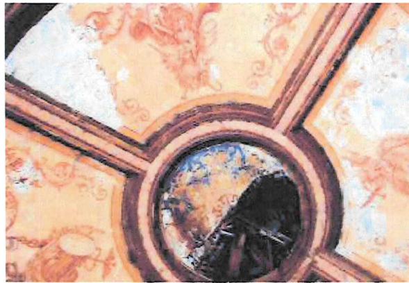
Deckenausschnitt mit Bauschäden.
